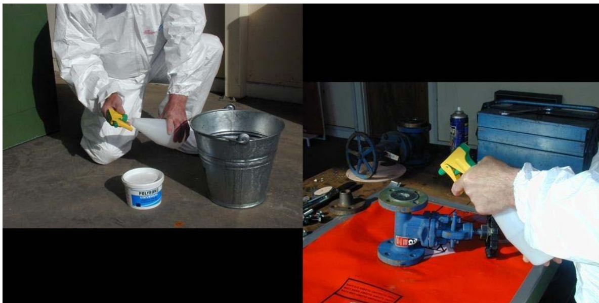
Slika 11.4 Vlaženje azbestne brtve na ventilu
