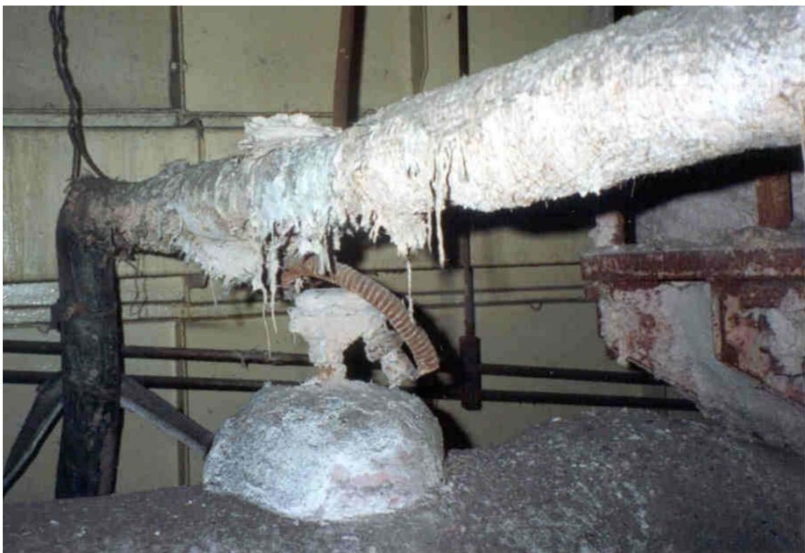
Slika 4.8 Azbestna izolacija na parovodima
