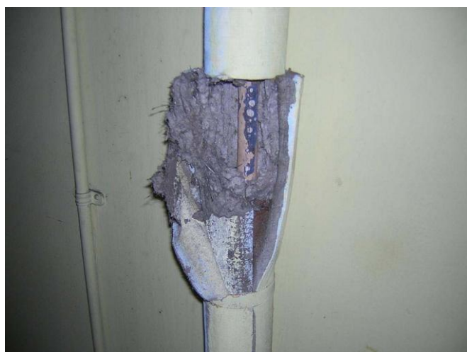
Slika 12.7 Izolacija azbestnih cijevi koja pokazuje više slojeva izolacije i prodiranje sredstva za vlaženje
