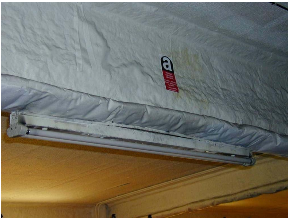
Slika 4.11 Izolacija od azbesta na konstrukcijskom čeliku.
