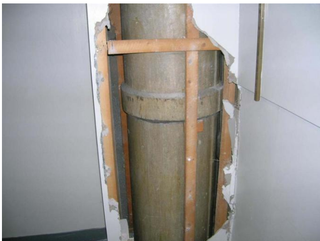
Slika 4.2 Djelomično uklonjena azbestna izolacijska ploča iza koje se vidi azbestno-cementna dimovodna cijev.
