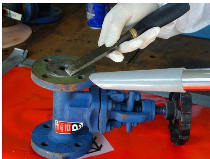
Slika 11.6 Kontinuirano usisavajte za hvatanje prašine koja se oslobađa prilikom čišćenja azbesta iz ventila.
