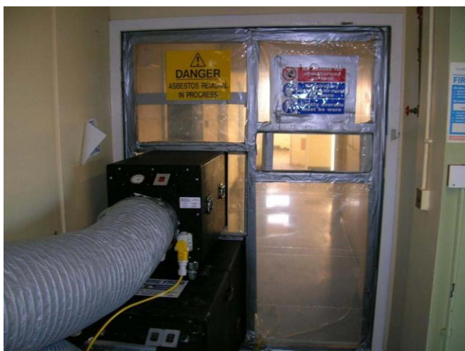
Slika 12.2 Jedinice za podtlak i kanali za odvod zraka, prozori i znakovi upozorenja.
